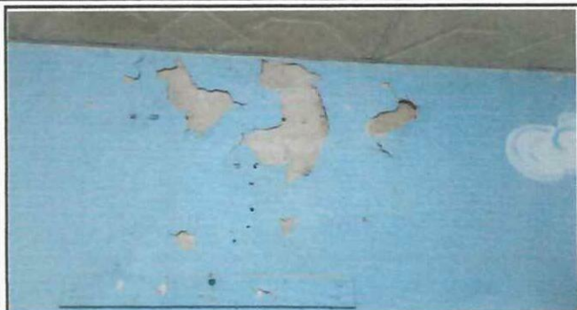
Foto 1: Repello de pared de calicanto con cernido, a paredes que se están desboronando, ya que tiene 91 años de contruida, provocando un severo deterioro.
