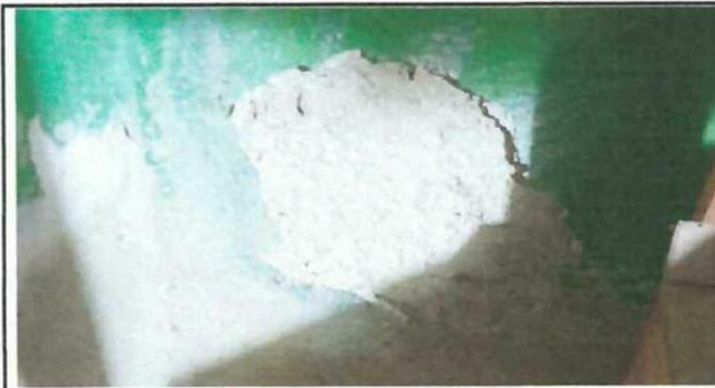
Foto 2: Repello de pared de calicanto con cernido, aula de las ovejitas que presenta severo deterioro por el paso del tiempo y la edad de construcción.
