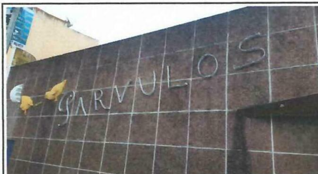
Foto 4: Mantenimiento de fachada principal, aplicación de antihaderente y barniz provocada por la humedad que se filtra desde el suelo y lo absorbe provocando serios daños.
